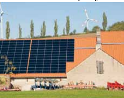
Solaranlage der Gutshof von Bismarck GbR in Braunsroda.
